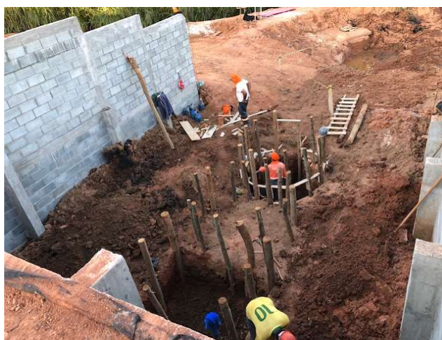
FOTO 27: ESTAÇÃO ELEVATÓRIA DE ESGOTO 1.
